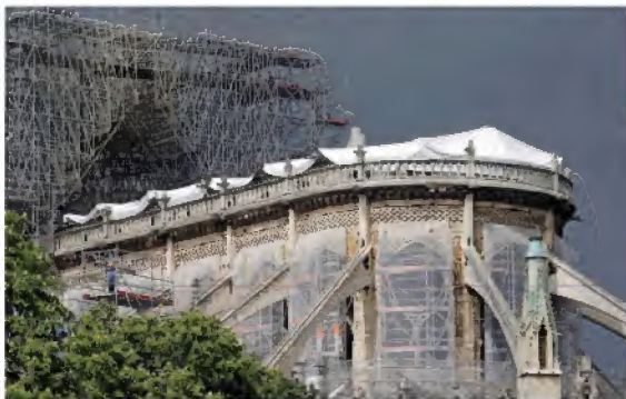
SOUTENIR, PROTÉGER En une quinzaine de jours, la cathédrale est bâchée, les statues et les vitraux menacés déposés et les pignons étayés.
